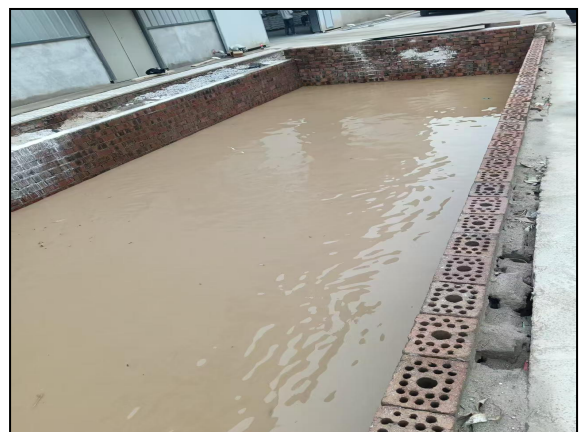
洗车废水沉淀池
